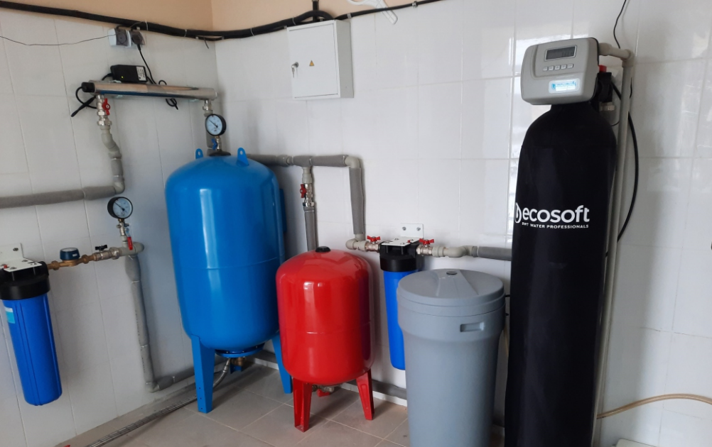
капітальний ремонт системи опалення та електрообладнання в приміщенні Красненського Першого закладу дошкільної освіти «Капітошка» Обухівської міської ради Київської області
